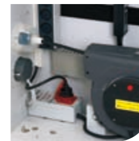
Kabelprolsysteem en stroomvertraging
